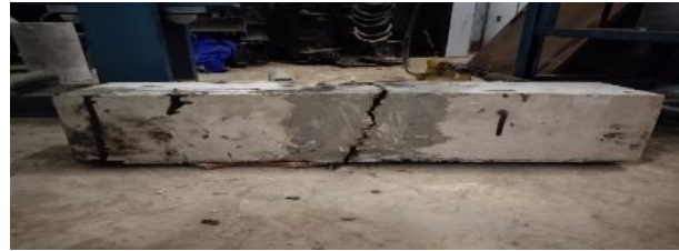
Gambar 8 Balok Umur 28 Hari setelah diinjeksi Epoxy
