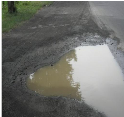
(e) Genangan Air Pada Bahu Jalan
