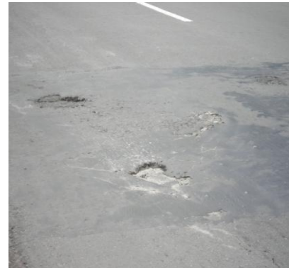
(f) Kondisi Permukaan Jalan km 36,6
