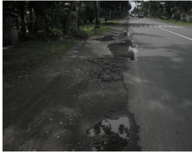
(b) Keadaan Bahu Jalan yang Rusak
