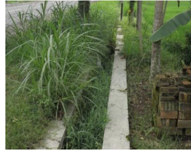
(c) Drainasi yang Tidak Terawat
