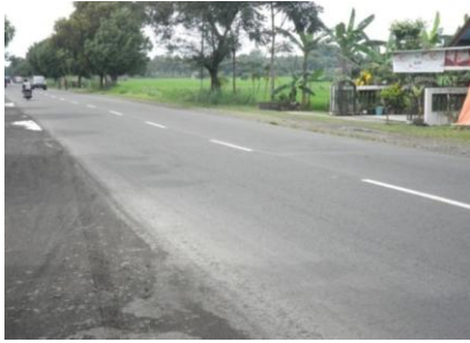
(a) Kondisi Umum Badan Jalan Yogyakarta-Purworejo
