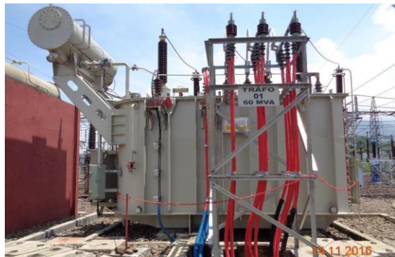
GAMBAR 2. Transformator tenaga 60 MVA di gardu induk Bumiayu, Jawa Tengah, Indonesia
